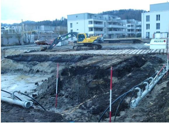
21. März 2010: Bald nach dem Spatenstich wurden die Sonden zur Entwässerung des Grundstücks in die Erde eingeführt, hier deutlich sichtbar als schwarze Schläuche, die in die metallenen Abflussrohre führen.
