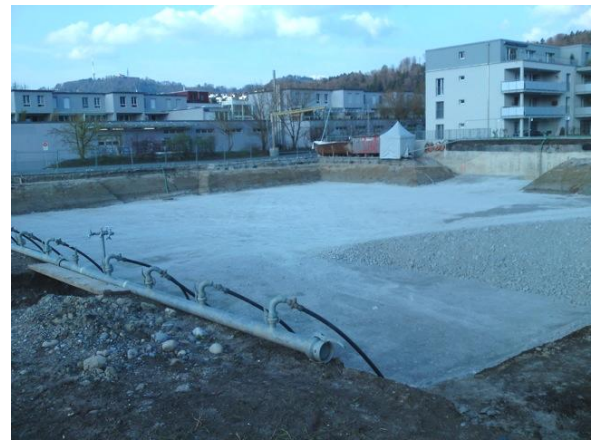
11. April 2010: Der Aushub ist fürs erste abgeschlossen; um den Grund für die schweren Baumaschinen zu stabilisieren, wird jetzt eine Kiesschicht von beträchtlicher Dicke eingelegt.
