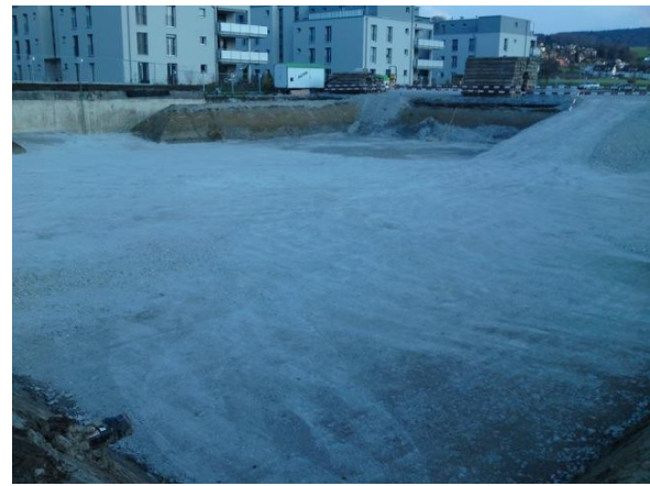
Auch eine Zufahrtsrampe wird aufgeschüttet. Im Übrigen läut noch immer die Entwässerung.
