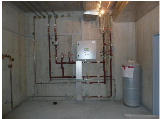
Die Heizung ist nun voll funktionsfähig...
