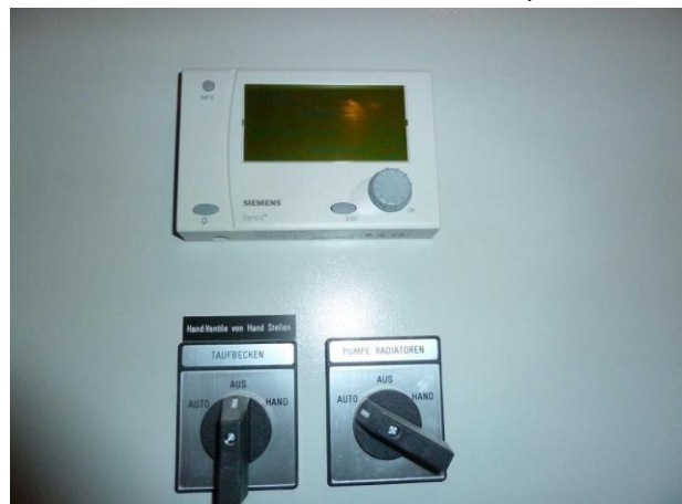
Detailansicht der Heizungssteuerung im Keller.
