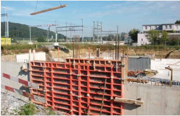
3. September 2010: Die Bodenplatte ist grösstenteils fertiggestellt, sodass mit dem Schalen und Betonieren der Tiefgaragenwände begonnen werden kann.
