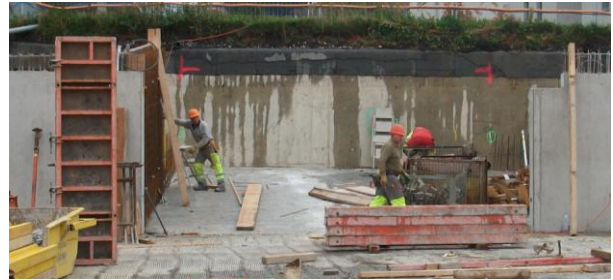
28. September 2010: Im östlichen Teil wird die Zufahrt fertiggestellt; bei der roten Markierung erfolgt der Durchbruch zur bestehenden Tiefgarage „Üetliblick“.
