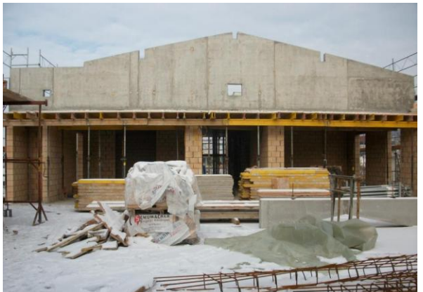
Hier ein Blick in die nördliche Richtung; gut erkennbar sind die beiden Klassenzimmer links und rechts des Gangs, die nach Bedarf mit einer verstellbaren Wand von der Kapelle abgetrennt werden können.
