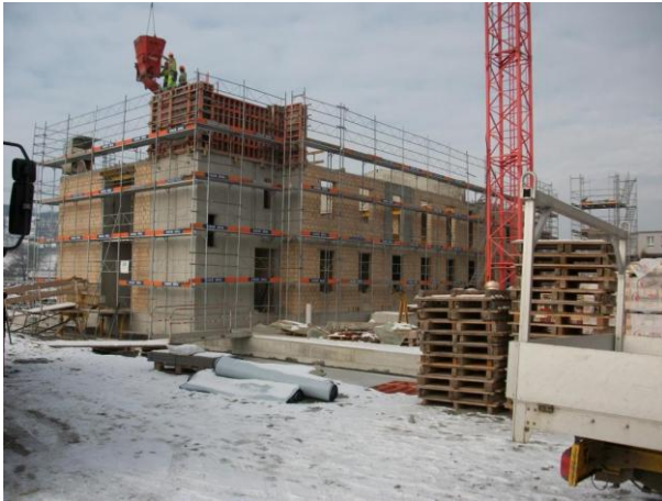
24. Januar 2011: Nach den Feiertagen ist die Witterung vorerst noch kalt, sodass die Arbeiten anfänglich relativ schleppend vorangehen.
