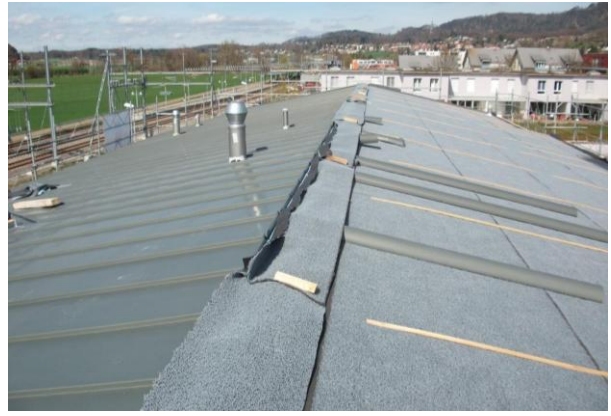
1. April 2011: Die Westhälfte des Daches ist Anfang April schon beinahe fertiggestellt, sodass die Ostseite in Angriff genommen werden kann.
