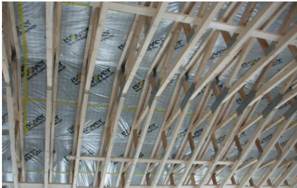
Mit den Arbeiten am Dachstuhl war bereits am 14. Februar begonnen worden; diese gehen schneller voran als vorgesehen und können schon früh im März abgeschlossen werden.
