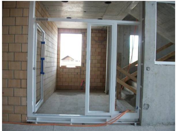
Im Übergang Korridor EG / Treppenhaus ist der Rahmen für den Windfang montiert worden.
