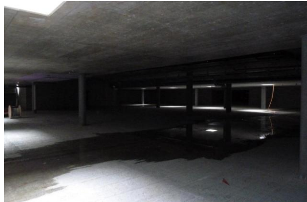
Die Tiefgarage: Beim Wasser handelt es sich um Regenwasser, das bei den Oblichtern/Rauchabzügen eingedrungen war und noch nicht austrocknen konnte. In den Boden werden zwei Rinnen eingelegt, durch die das Wasser, das durch nasse Autos in die Tiefgarage gelangt, abfließen kann. Dies ermöglicht es auch, die Tiefgarage bei Bedarf mit Wasser auszuspritzen.
