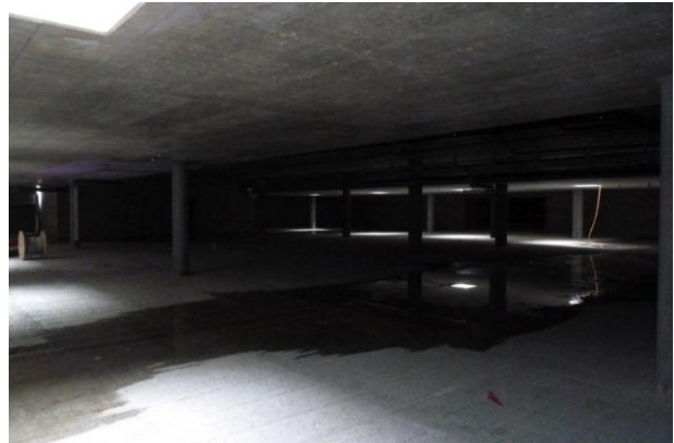
Die Tiefgarage: Beim Wasser handelt es sich um Regenwasser, das bei den Oblichtern/Rauchabzügen eingedrungen war und noch nicht austrocknen konnte. In den Boden werden zwei Rinnen eingelegt, durch die das Wasser, das durch nasse Autos in die Tiefgarage gelangt, abfließen kann. Dies ermöglicht es auch, die Tiefgarage bei Bedarf mit Wasser auszuspritzen.
